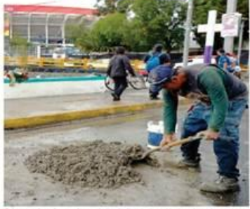
■ A marchas forzadas y entre la lluvia, continúan las obras fuera del Estadio mundialista en la CDMX.
